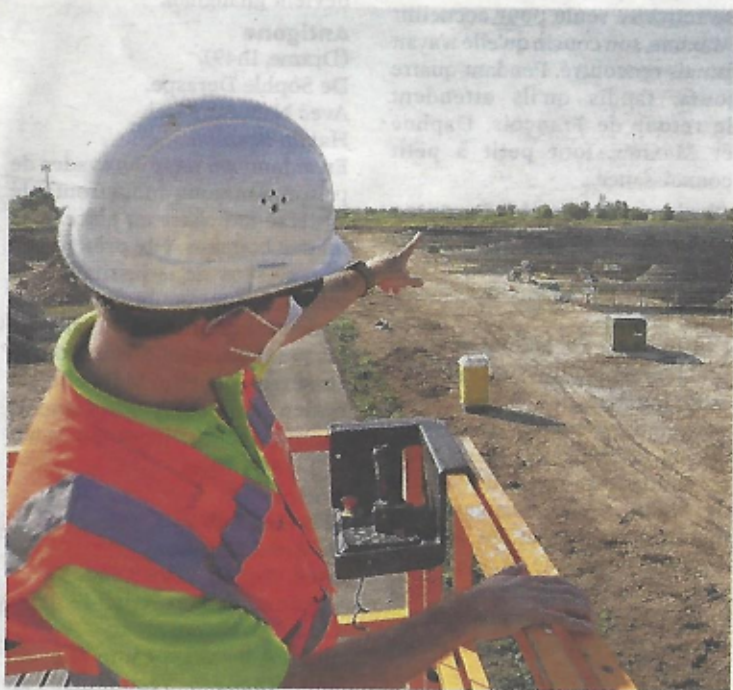
La totalité de l'installation occupera 70 hectares, sur les 90 de l'ancienne Martinerie.
